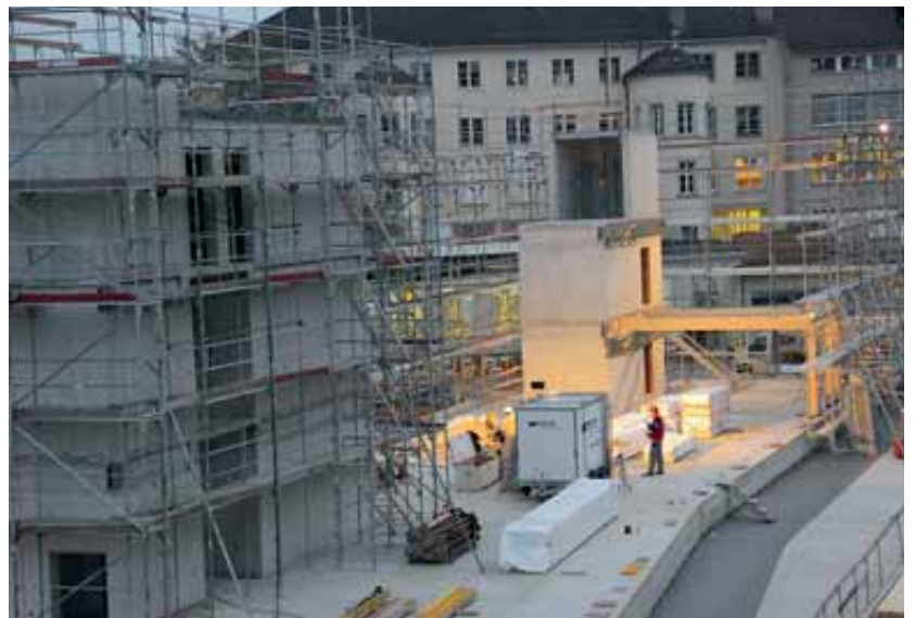
La costruzione del Laur-Park è stato molto seguito. Nella foto il futuro edificio adibito ad uffici.
